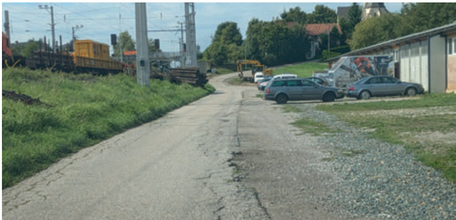
Beschädigte Fahrbahnränder und Schlaglöcher zeigen den Sanierungsbedarf vieler Gemeindestraßen.
