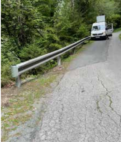
Leitschienen Reißkofelbad Straße
