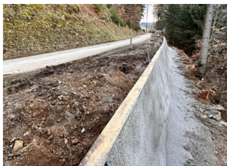
Wiederherstellungen nach den Unwettern
